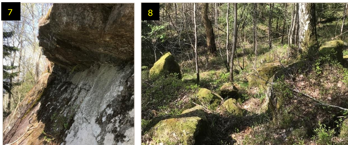
Figur 9. Lokal 5. I bild 7 visas spår av tidigare blockutfall, och tidigare blockutfall i slänten i bild 8.
