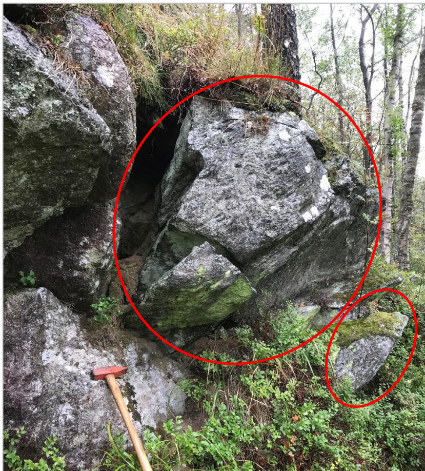
Figur 7. Lösa block i skärningen som riskerar att falla ut mot bebyggelse.
