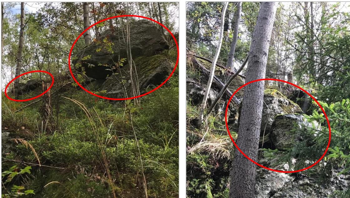
Figur 10. Stora lösa block ligger högt upp i slänten och riskerar att rasa ner mot bebyggelsen nedanför.
