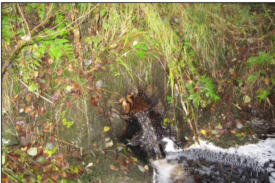
Figur 6. Trumma under grusväg som ligger längs den sydvästra sidan av planområdet (BTG300).
