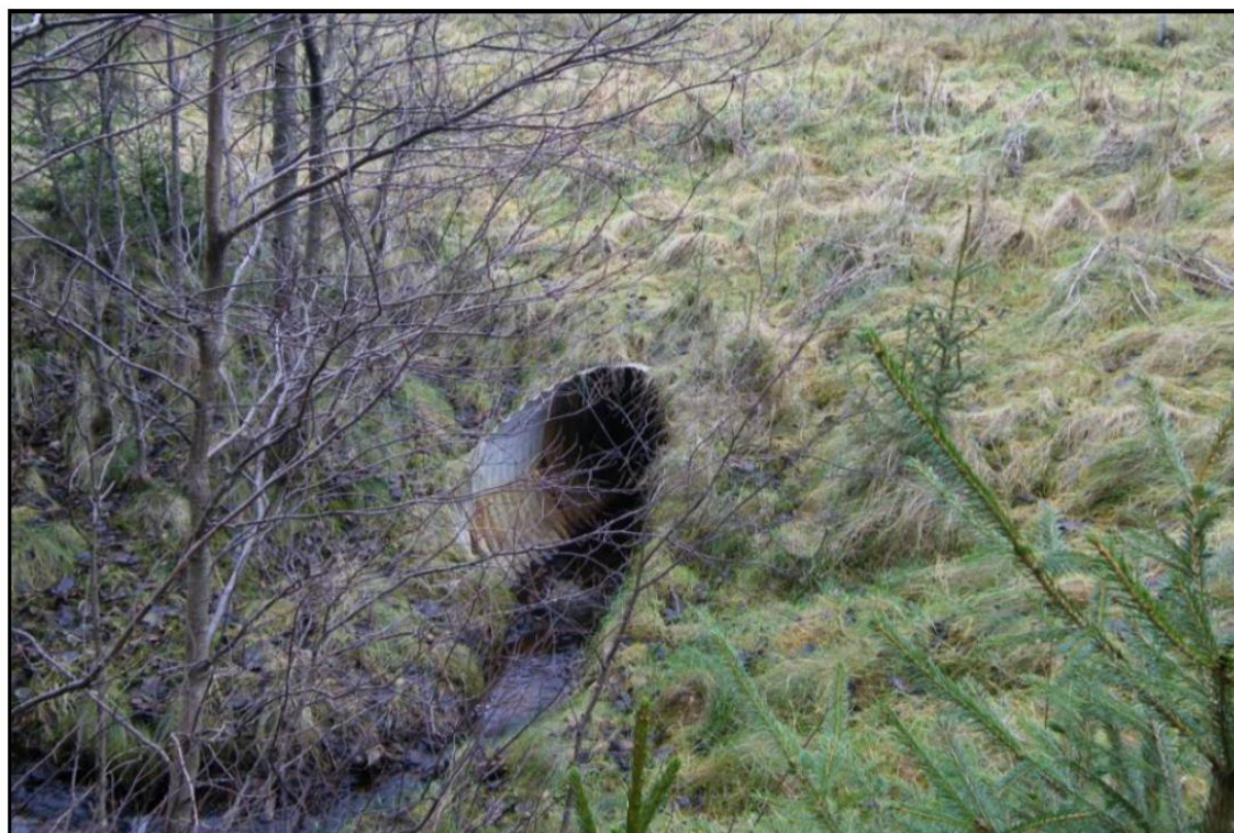
Figur 4. Trumma under Rv 40 (PLÅT1400).
