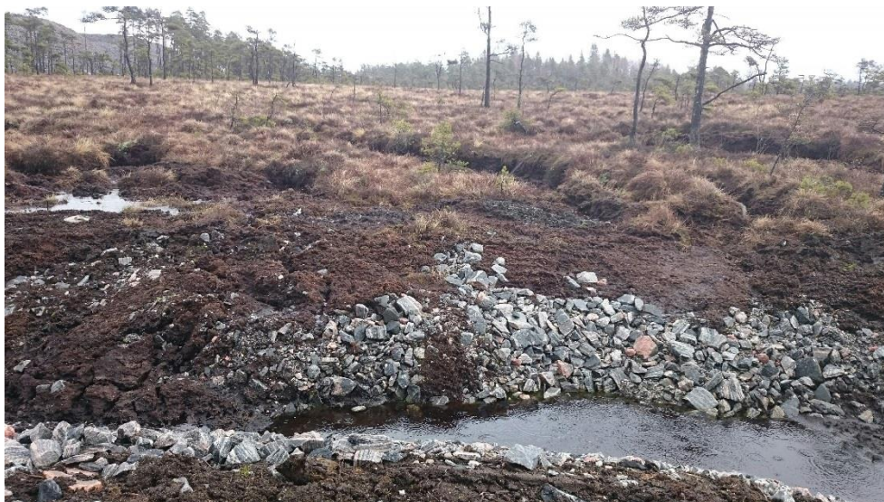
Figur 8 Bild på kant där sprickor i mosstället upptäckts
