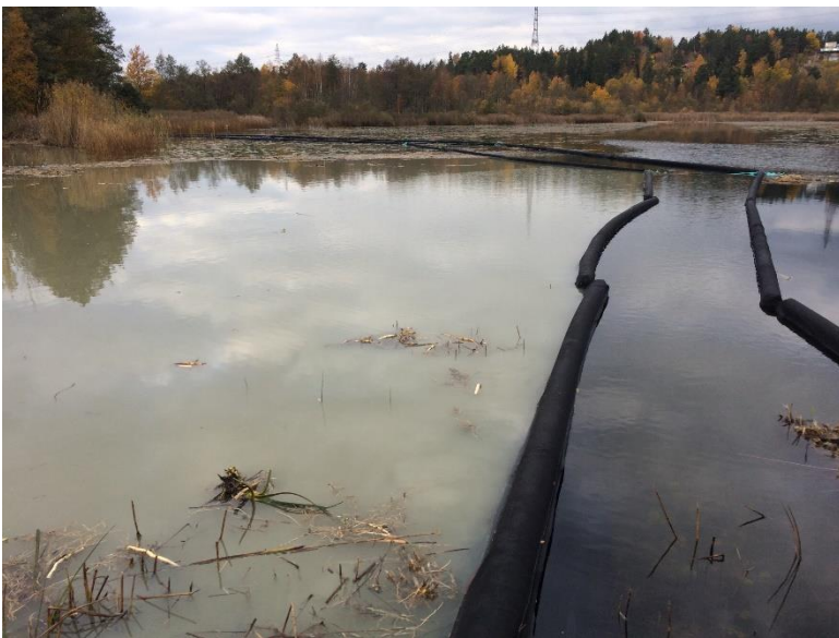
Figur 9 Dubbla siltgardiner som anbringats vid arbete med utfyllnad i Väsjön, Sollentuna kommun.
