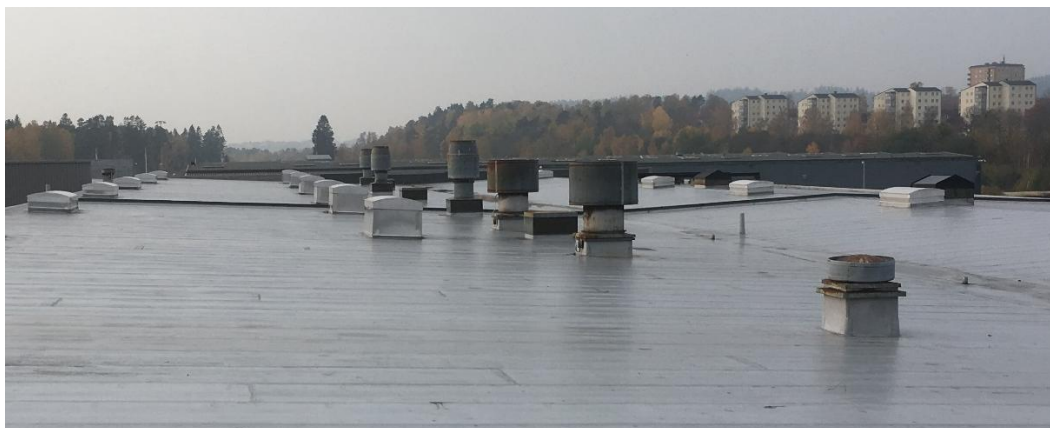
Figur 9. Byggnadens övre tak har ett stort antal fläktar som använts i tidigare verksamhet, men som numera är tagna ur bruk.
