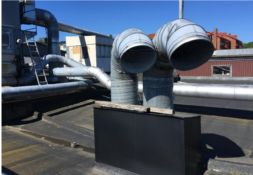
Figur 12 – Ventilation på taket.
