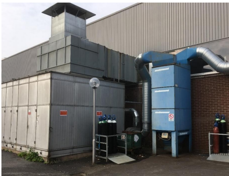
Figur 10. Fläkt med filter till Lernias verkstadslokal.
