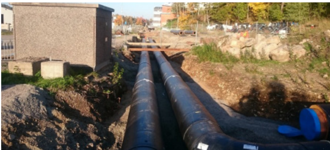
Fjärrvärmerör utmed Kilsundsgatan.
